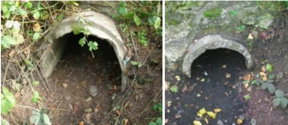
Figure 41: Collecteur T100 (à droite) et collecteur DN 500 mm obstrués (à gauche)
