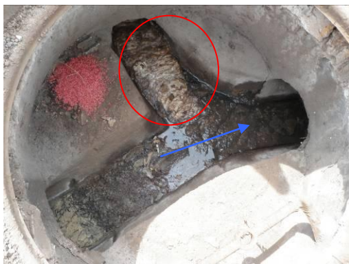
Tampon P674 de la rue des Vieilles Vignes : tête de réseau : mauvais branchement de particulier.
