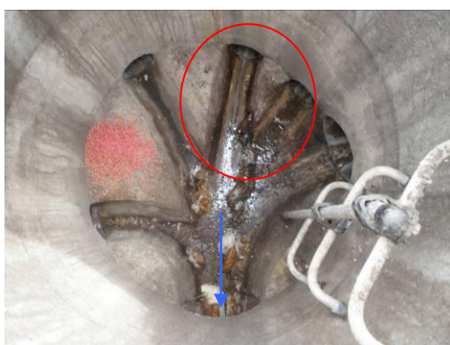
Tampon P3056 de la rue Stevenson : tête de réseau : mauvais branchement de deux particuliers.
