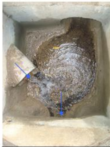
Tampon P119 : arrivée de la source : 2 cm d'eau pour un collecteur de Ø200
