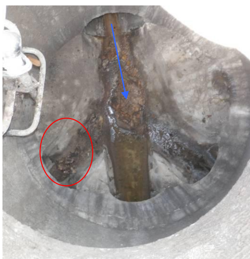
Tampon P3059 de la rue Stevenson : mauvais branchement venant de P3051.
